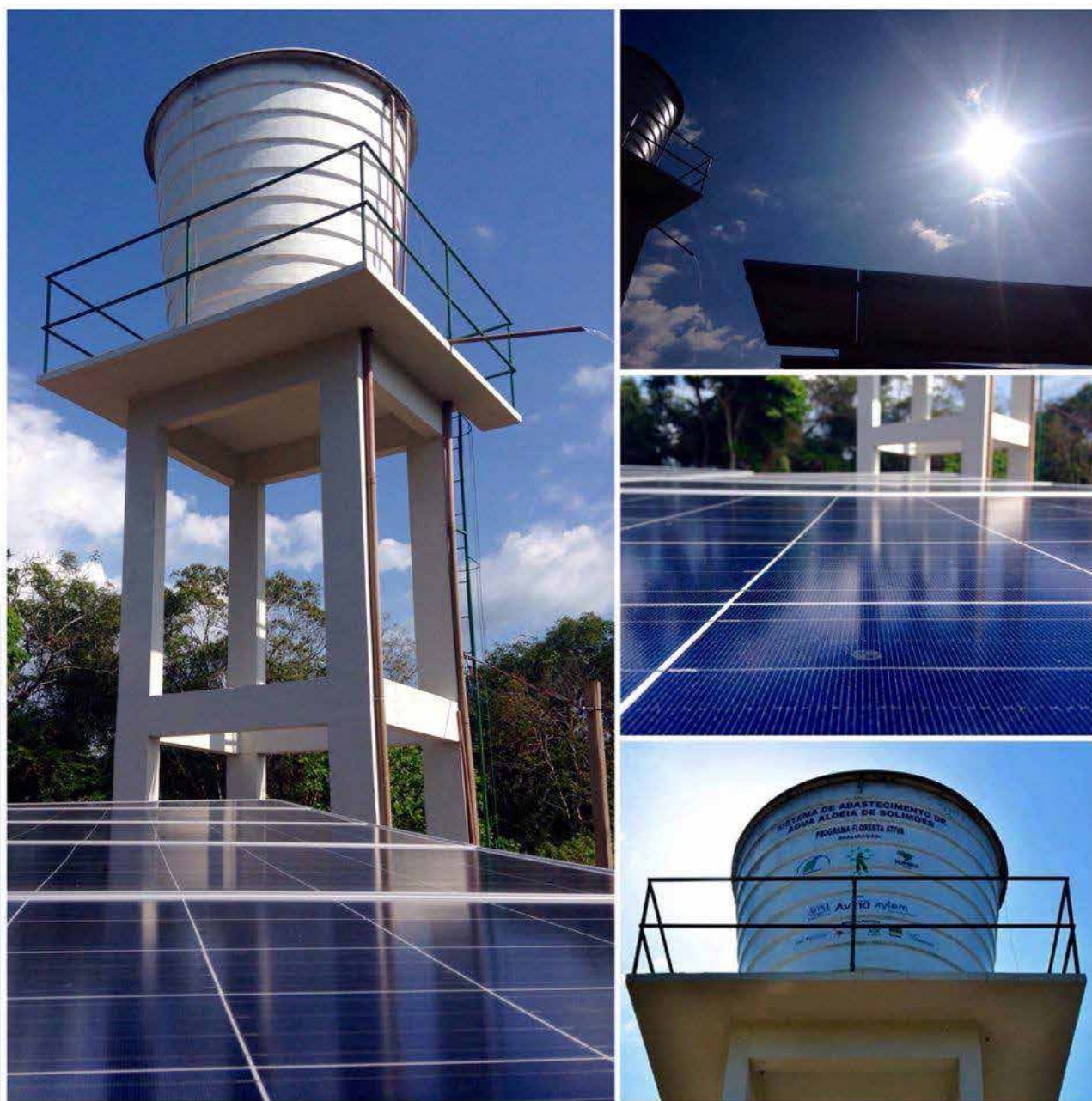
Figura 16 Caixa D'água Sistema Solimões.
